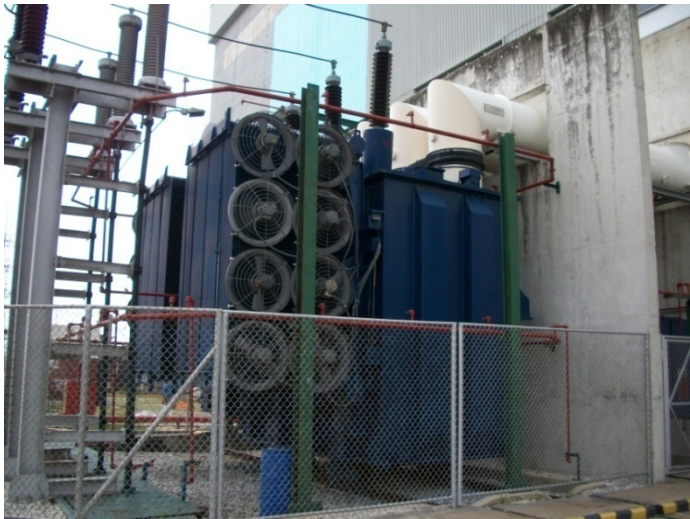
Ilustración 4. Transformador MT1 Lado lateral derecho.
