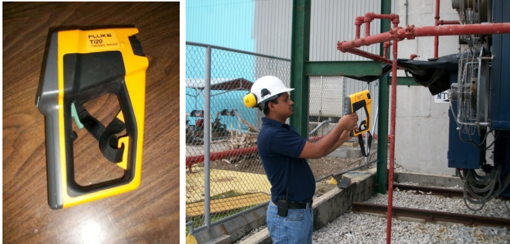
Ilustración 14. a) Cámaras Termográficas b) Prueba en el transformador.
