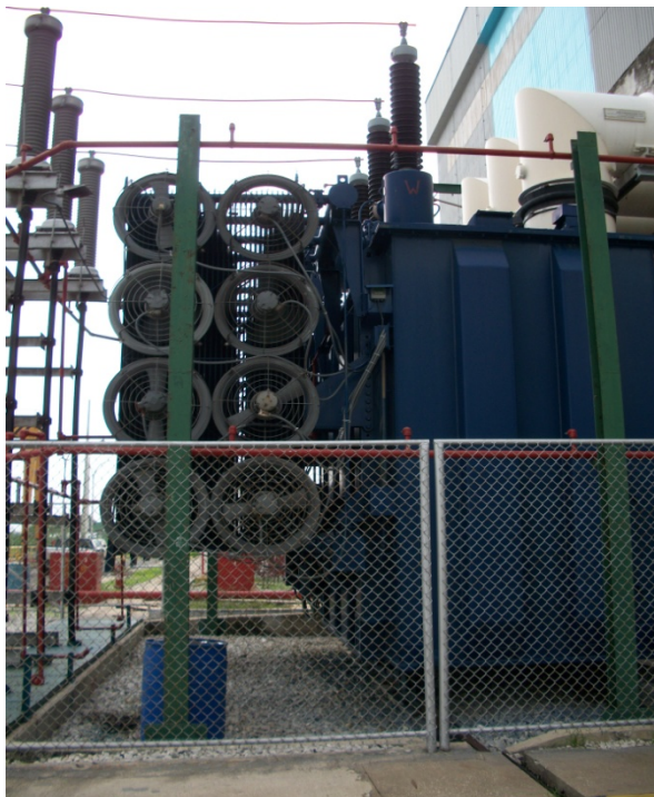
Ilustración 5. Transformador MT1 Lado lateral de Bushing.
